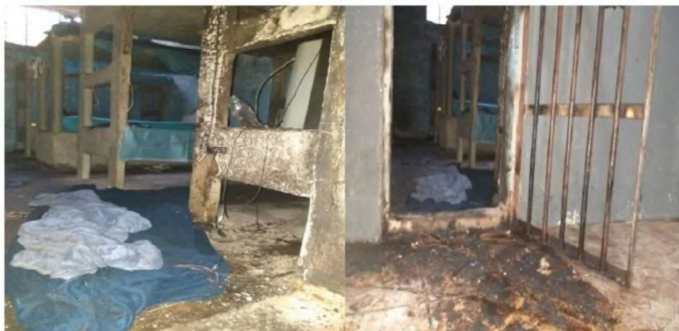
Figura 2 - Alojamento que sofreu um curto circuito elétrico
