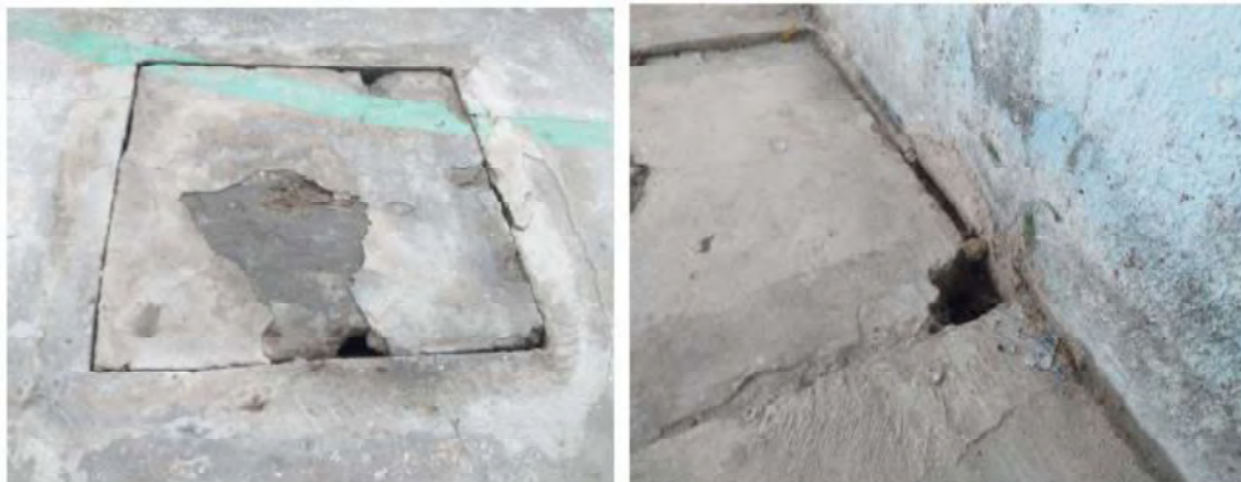
Figura 1 - Bueiro quebrado Dom Bosco
