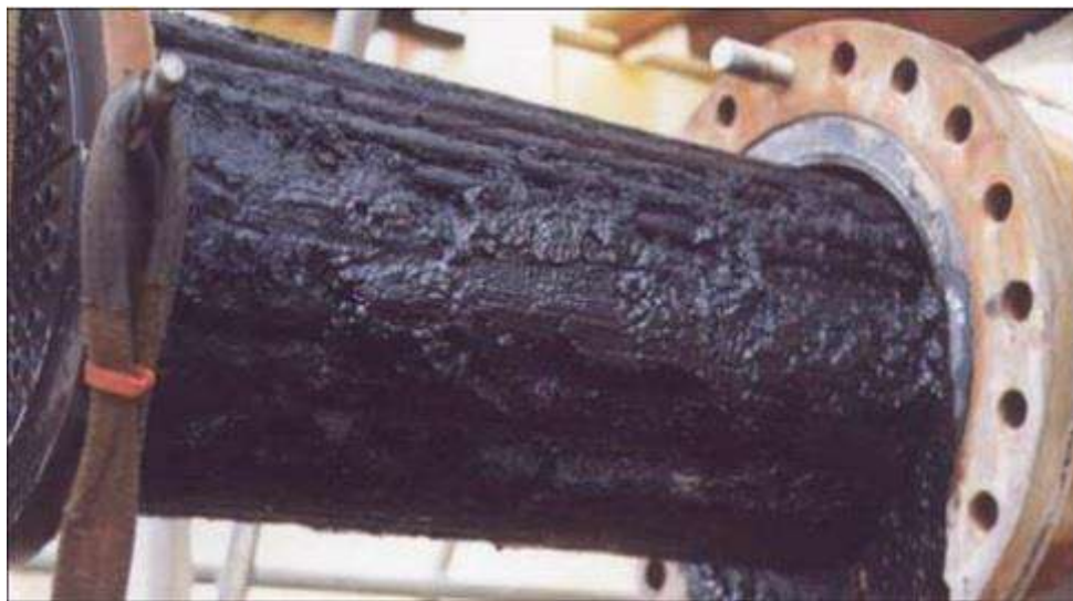
Figura 15: Incrustação em Reboiler usado no processo convencional de recuperação de MEG
