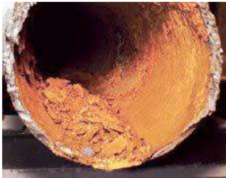
Figura 22: Exemplo de efeitos de corrosão em equipamento de plataforma offshore
