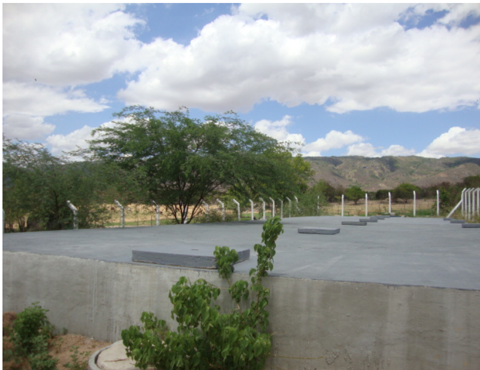
Figura 10: Vista panorâmica da estação de tratamento de esgoto da comunidade indígena Fulni-ô. (Autor: Bruno M. M. Bardano. 2013).
