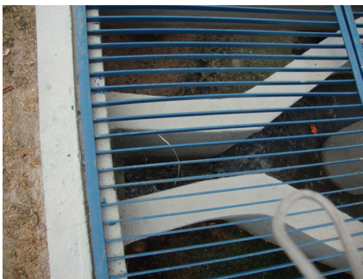
Figura 9: Estação de tratamento de esgoto da comunidade indígena Fulni-ô. Sistema de gradeamento e medição de vazão. (Autor: Bruno M. M. Bardano. 2013)
