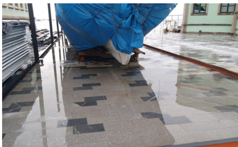
Figura 57 - Empoçamento após as chuvas
