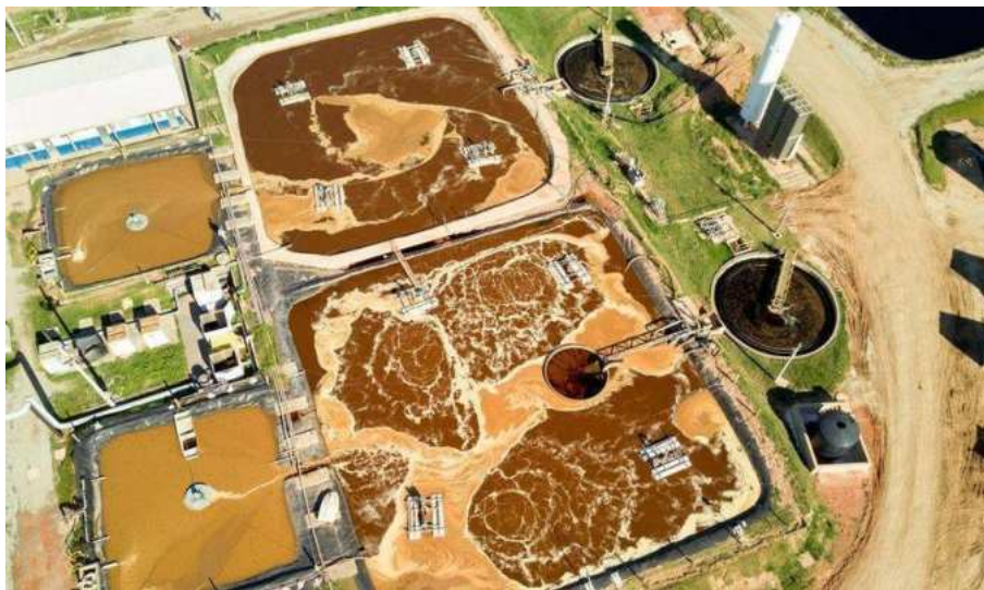
Figura 8 - Base de tratamento de chorume da empresa Ciclus Ambiental
