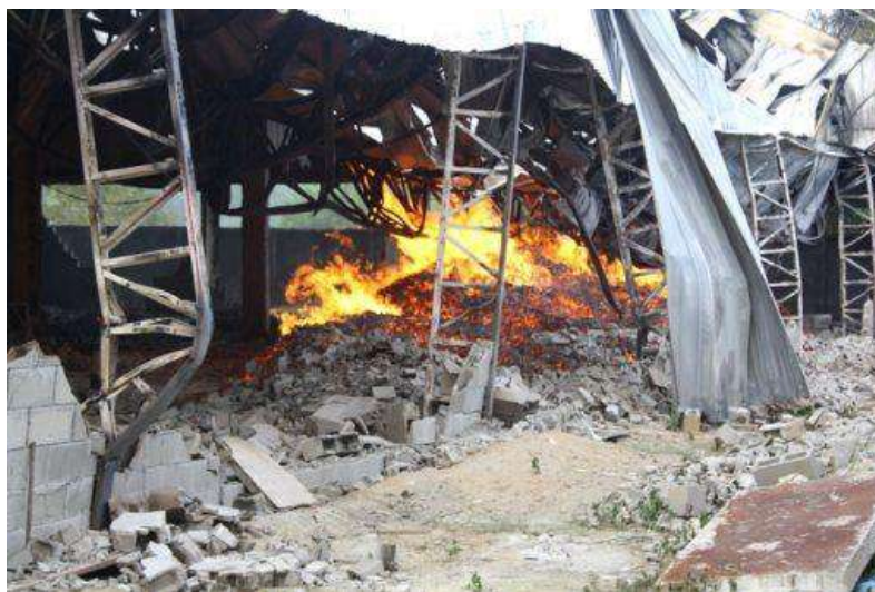
Figura 1.4: Estrutura sob incêndio. Fonte: https://www.engenheirodoaco.com.br/2018/10/02/estruturas-de-aco-em-situacao-de-incendio-0033/ .
