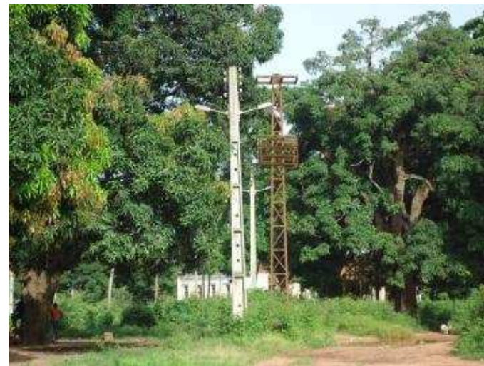
Foto 12: poste e torre de iluminação pública (Fonte: autor, 2012).
