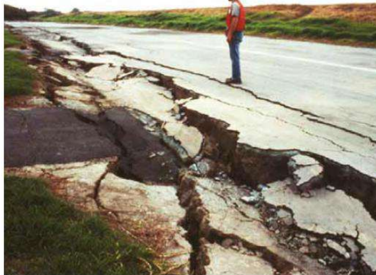
Figura 10 - Fotografia de um espalhamento lateral ocorrido em uma rodovia, como resultado do terremoto Loma Prieta, em 1989, na Califórnia, EUA
