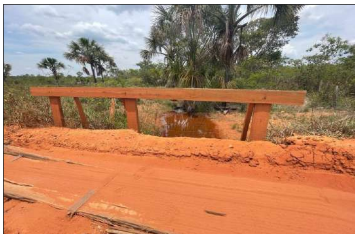
Figura 5.25 - Sedimentos sobre a ponte e na vereda do Purgatório, afluente do rio Formoso, a jusante da estação de monitoramento FOR03
