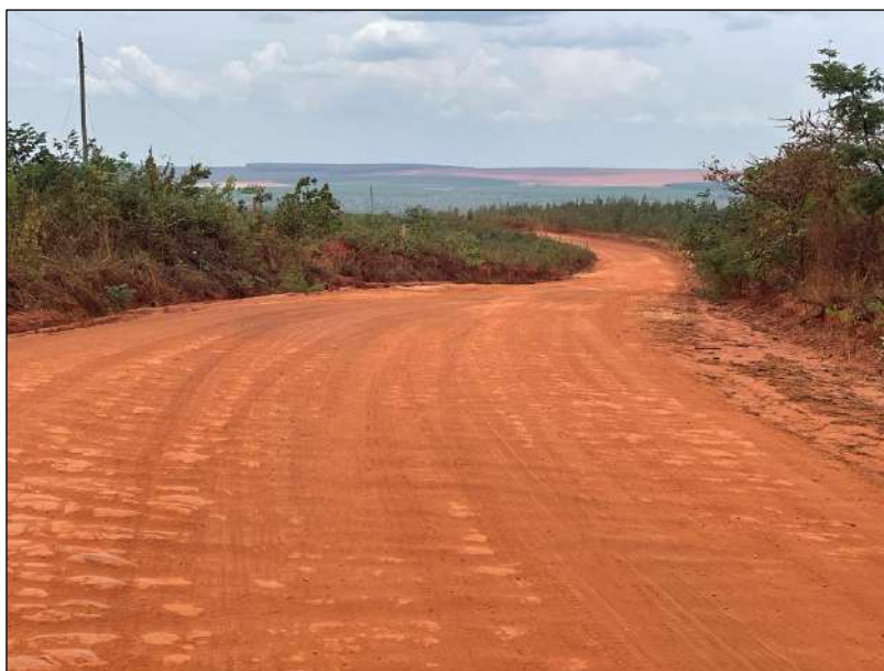
Figura 5.16 - Trecho da estrada rural da bacia que dá acesso ao distrito Sambaíba de Minas e às propriedades rurais da região sem os mecanismos de controle de erosão do solo
