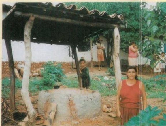
Forno danificado de Agostinha Gomes (Campo Alegre)
