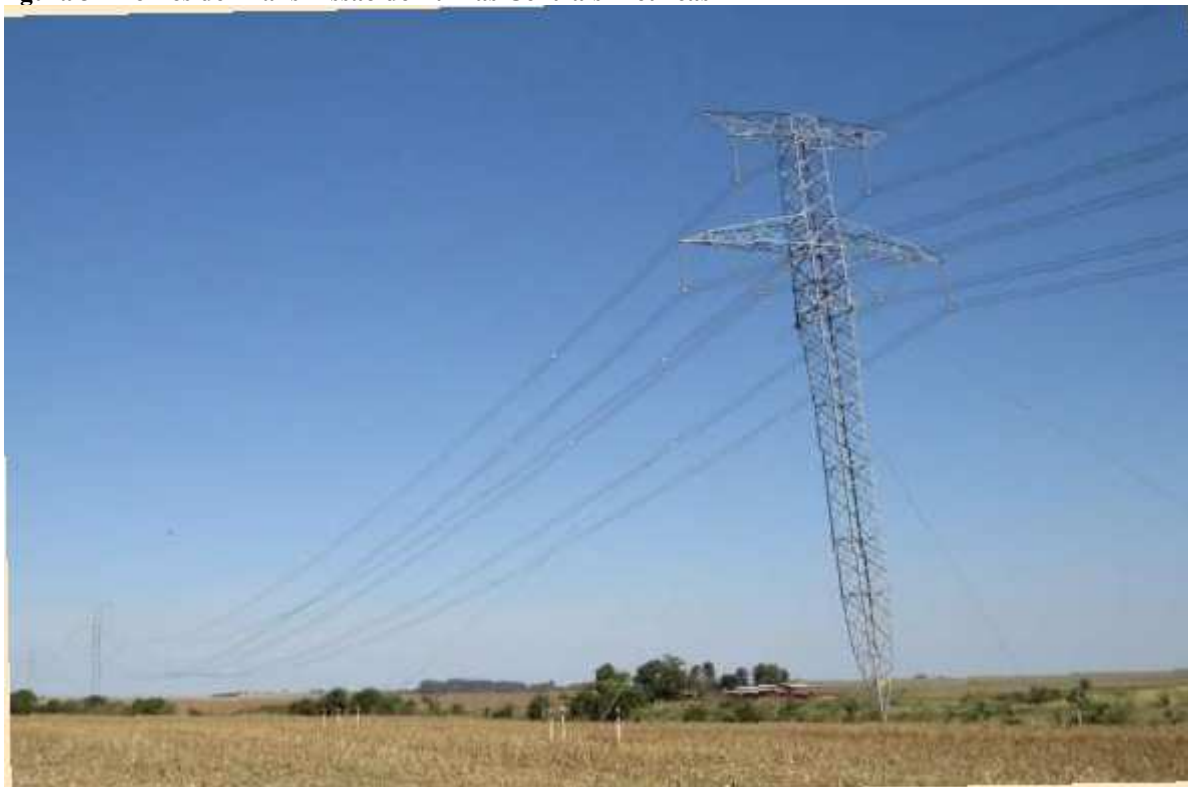
Figura 3 - Torres de Transmissão de Furnas Centrais Elétricas
