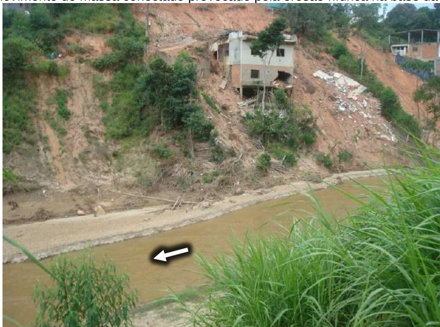
Figura 61 - Movimento de massa conectado provocado pela erosão hídrica na base da encosta
