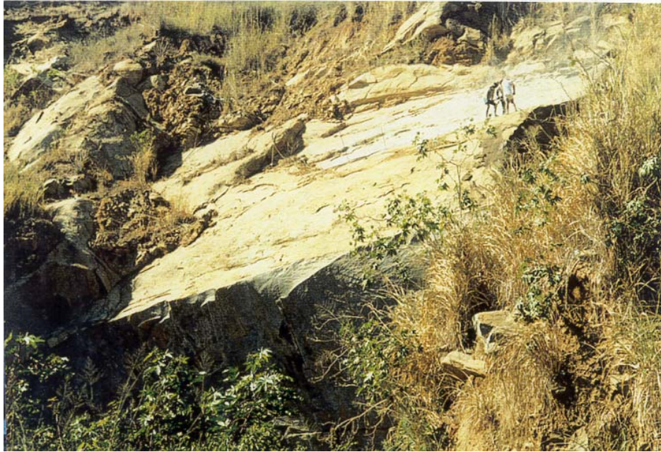
Figura 40: Martelete a ar comprimido, sendo utilizado para abertura de canais no maciço.
