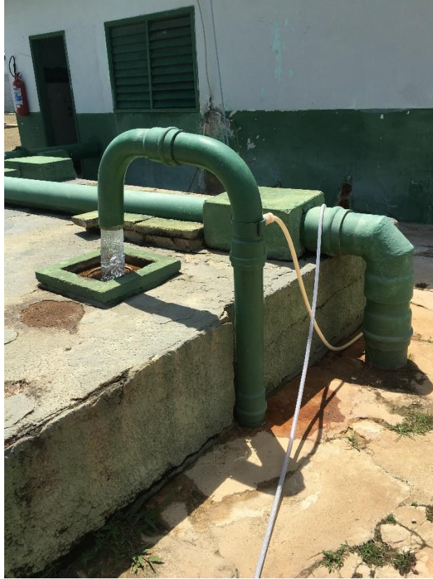
Figura 19: Poço tubular utilizado para coleta de amostra
