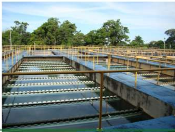
Figura 20 – Tanques de armazenamento de água na ETA de Jurtunaíba.
