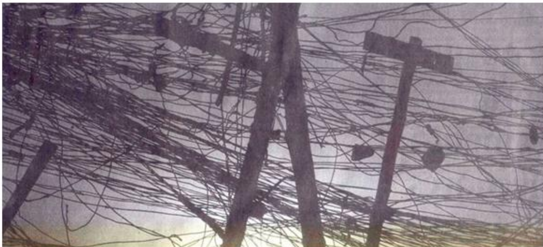
Emaranhado de fios que mostra provável furto e desperdício de energia.
