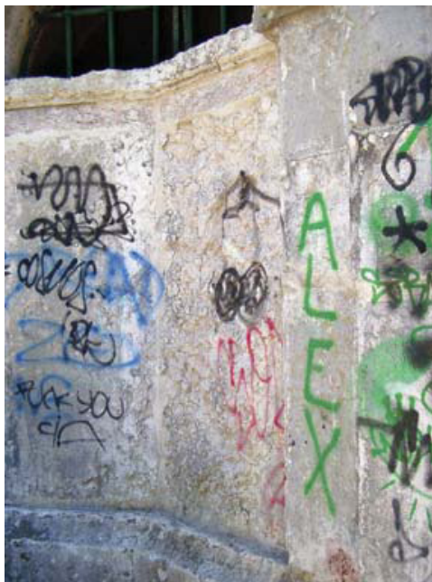
Figura 17 – Fotografia que exemplifica a ação antrópica sobre um monumento pétreo: pichação em aqueduto em Portugal. Imagem retirada de: Illustrated Glossary on Stone Deterioration Patterns , ICOMOS, 2008, p.57.
