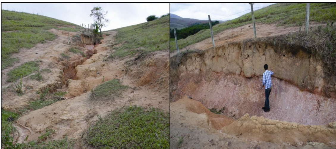
Figura 5.22: Imagens do ponto TR-CZ-03. À esquerda, pode-se ver a ravina onde está o afloramento da Formação Barreiras, na imagem da direita.
