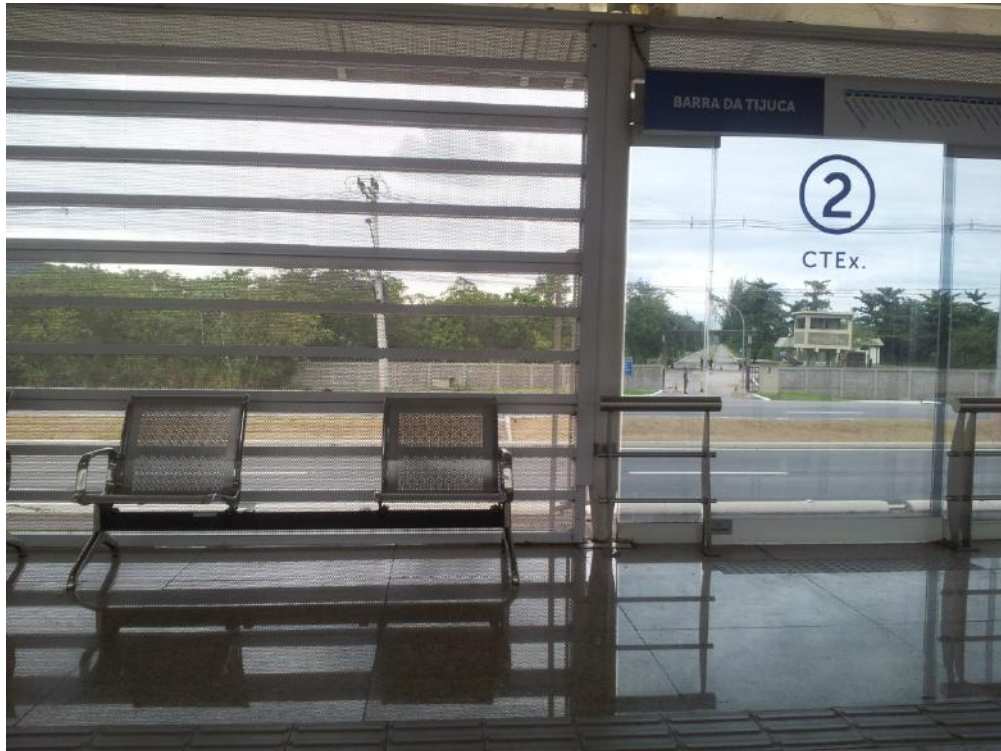
Figura 11: Estação CTEx com equipamento defeituoso
