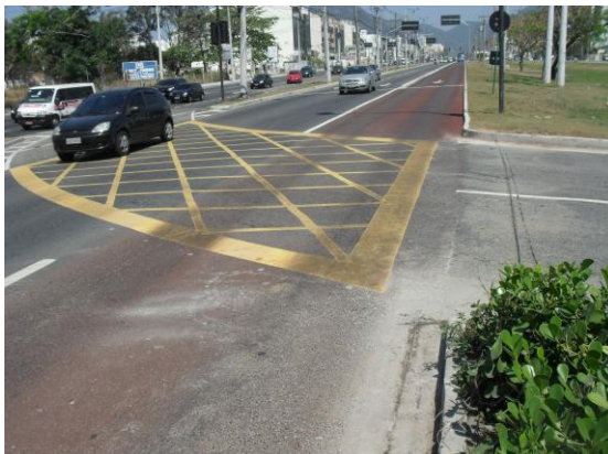
Pintura gasta no asfalto do corredor expresso. Foto do autor.
