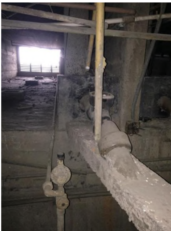
Figura 3 – Tubulação no qual o efluente do tanque de acúmulo se encontra com a rede de esgoto abastecida de estação de tratamento da CEDAE.
