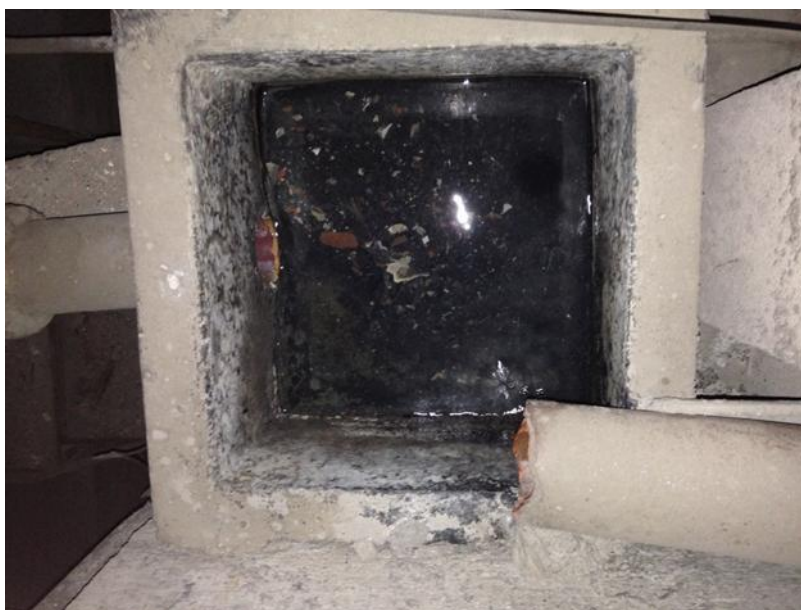
Figura 2 – Tanque de acúmulo, onde foi realizada a amostragem.
