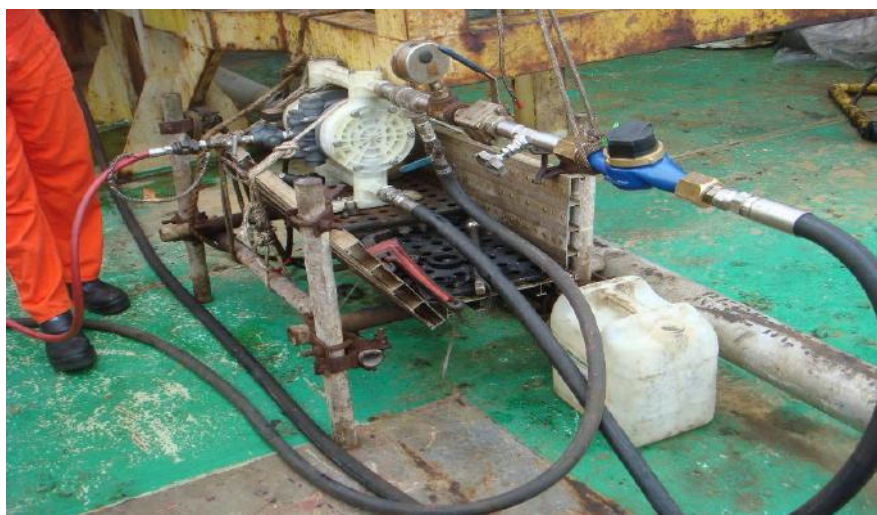
Figura 21 – Sistema provisório de injeção de sequestrante de H 2 S para offloading adaptado. (Imagem cedida pela Petrobras UO-BC).
