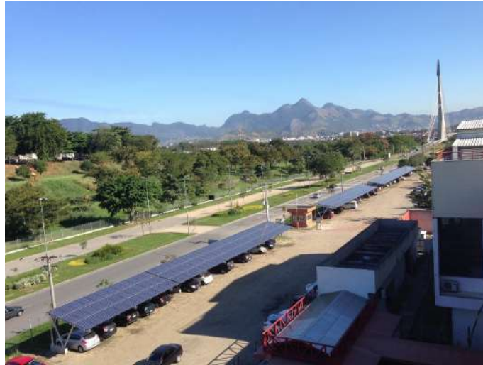
Figura 2.2: Conjunto de Painéis Solares Fotovoltaicos - Estacionamento Solar UFRJ - Fonte: Fundo Verde. Disponível em: http://www.fundoverde.ufrj.br .
