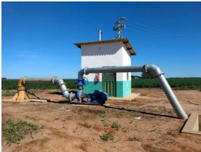
Figura 8 Foto de poço tubular em fazenda na área de estudo
