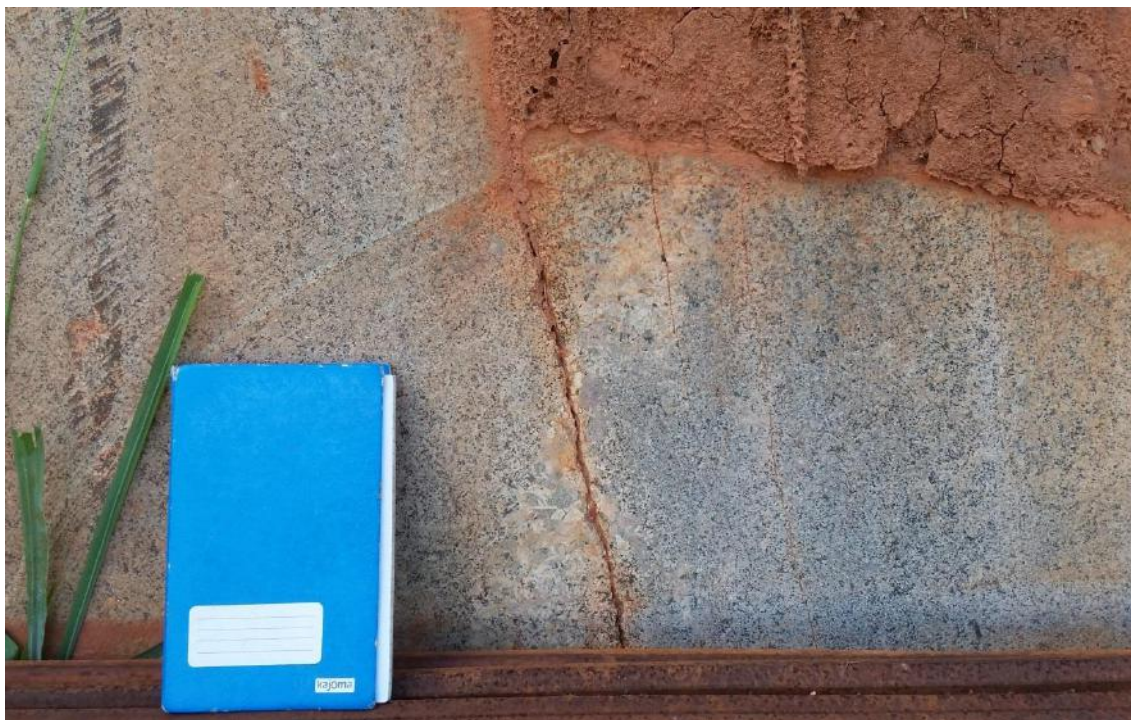
Figura 20 - Corte escolhido para analisar descontinuidades. Fratura ocorrendo na direção oposta ao veio aplítico.
