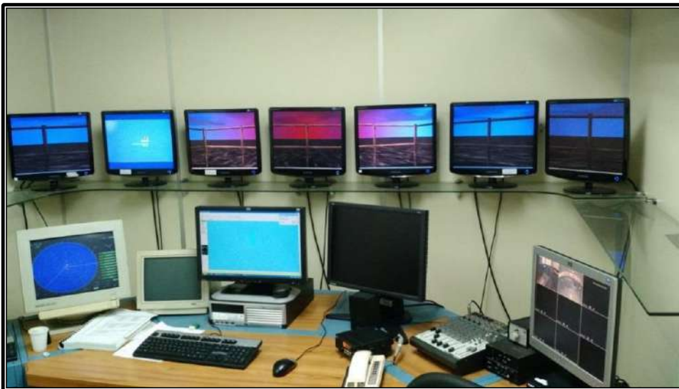
Figura 15: Sala de Controle
