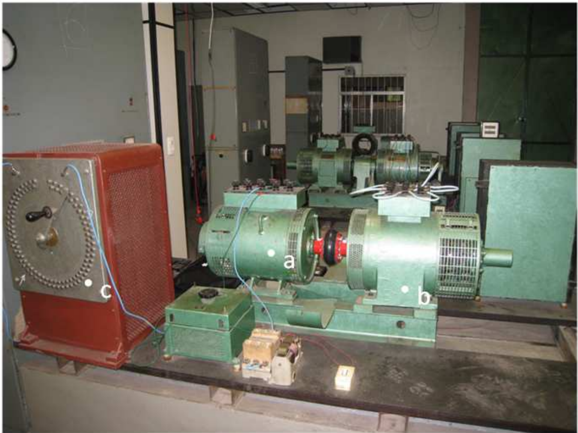
Figura 28 – Foto do grupo gerador
