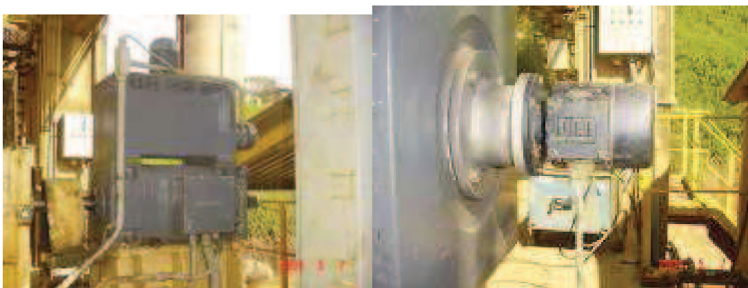
Figura 76 – Motor de Corrente Contínua com o Tacômetro em sua Extremidade. Geralmente, estes motores têm pequenos mancais que podem ser monitorados na mesma maneira como qualquer mancal (técnica do envelope, por exemplo) [30]
