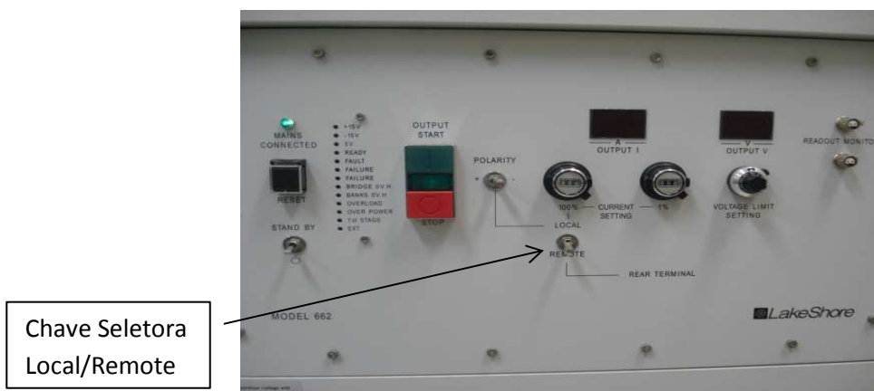
Figura 10 - Foto do painel frontal da fonte de corrente, destacando a chave seletora Local/Remote.
