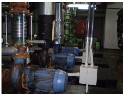
FOTO 4.6.1: Motores do prédio
