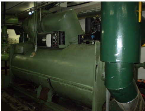
FOTO 4.5.1: Chiller do prédio
