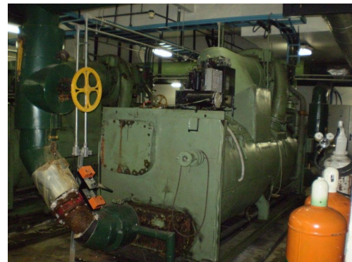
FOTO 4.5.2: Chiller do prédio
