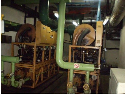
FOTO 4.5.3: Chillers do centro de convenções
