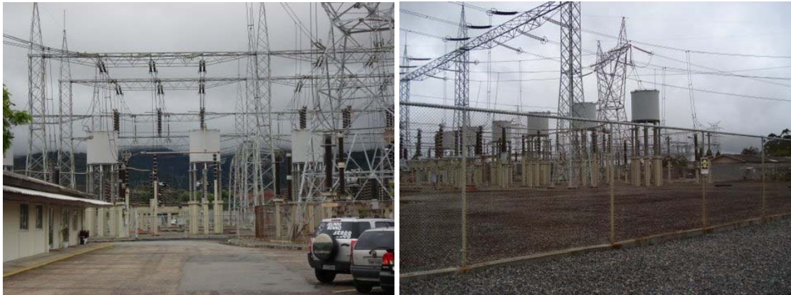
Figura 4.1 - Reatores limitadores da Subestação de Mogi das Cruzes
