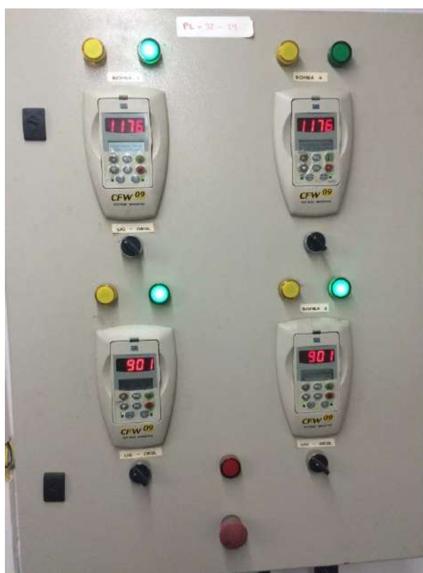
Figura V.20 – Painel de controle para controlar a velocidade do fluxo de água.
