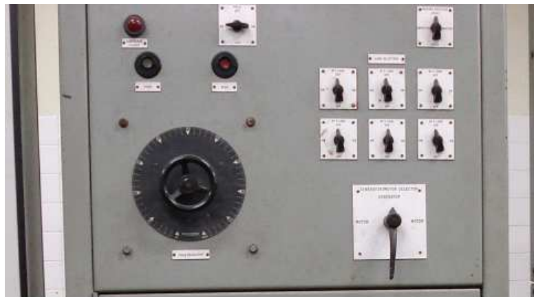
Figura 16 - Painel para acionamento de motor.
