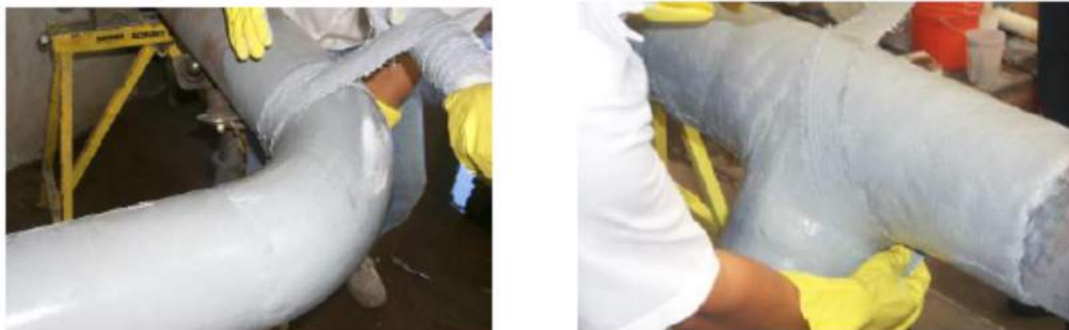
Figura I.18: Reparos utilizando a marca comercial Armor Plate Pipe Wrap [4]. (a) Curvatura STD 6” (50% corrosão). Sem reparo: 4532 psi. Reparado: 6780 psi. (b) Te STD 6” (50% corrosão). Sem reparo: 6546 psi. Reparado: 7500 psi
