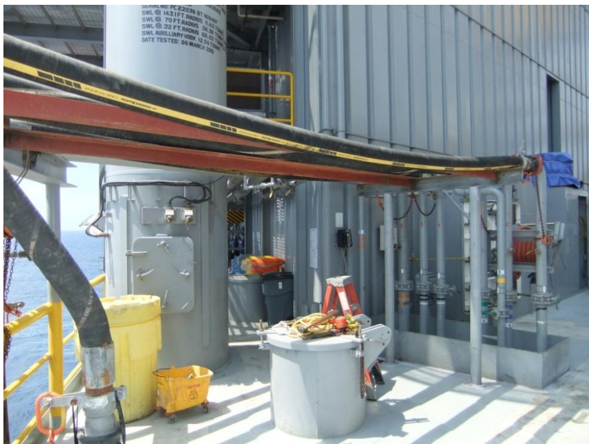
Figura IV.11: Estação de transferência de fluidos com os mangotes posicionados sobre o convés e maior bacia de contenção.
