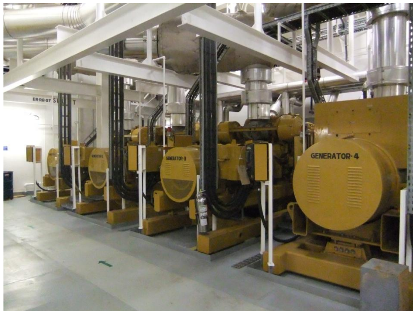
Figura IV.6: Sala dos geradores na praça de máquinas.
