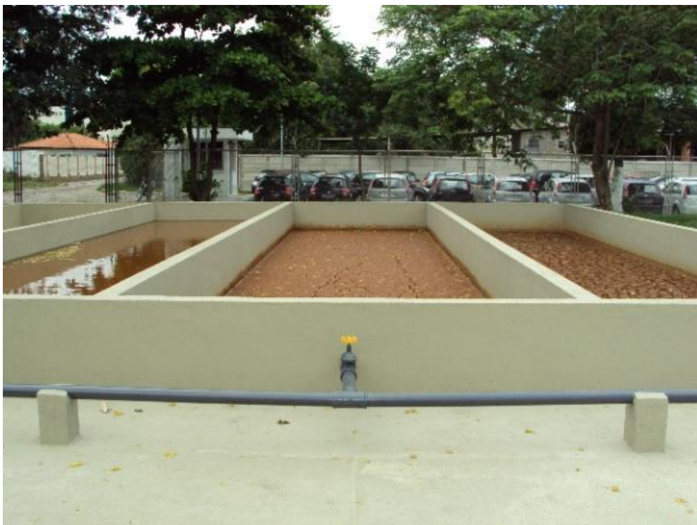
Figura 8: Leitos de Secagem da ETA.
