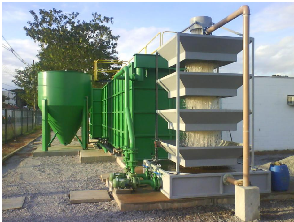
Figura 5: Estação de Tratamento de Água (ETA) do AIRJ.
