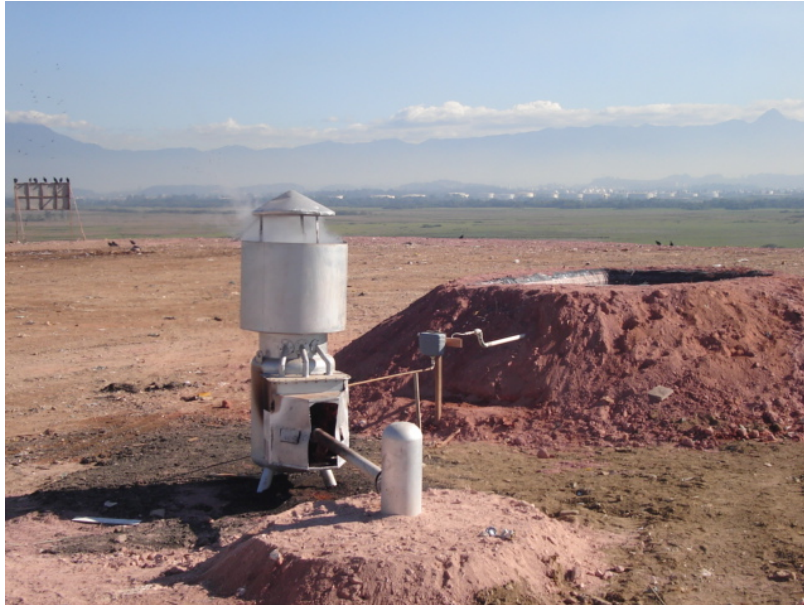
Figura 2.8 - Evaporador Unitário a Gás em Gramacho (BACELAR, 2008)
