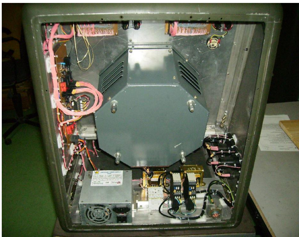
Figura 5.20 – Vista do interior do gabinete
