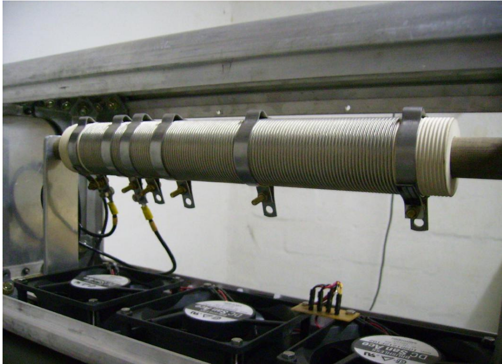
Figura 5.12 – Carga resistiva e coolers
