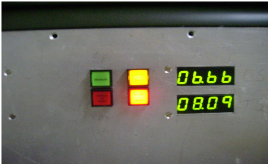
Figura 5.15 – Displays exibindo tensão e corrente de saída
