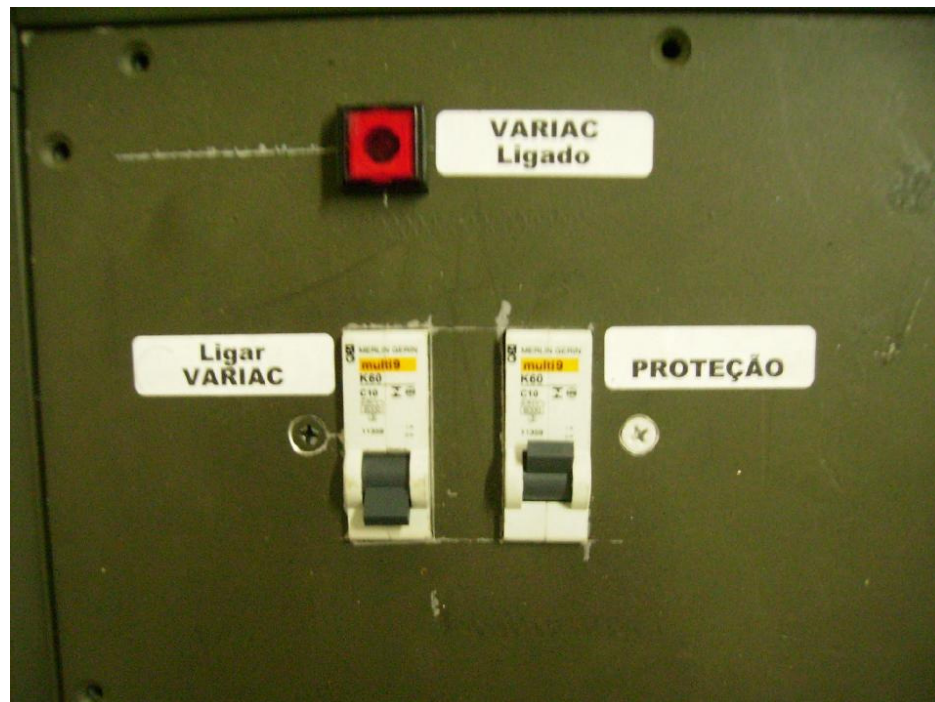
Figura 5.13 – Disjuntores e sinaleira
