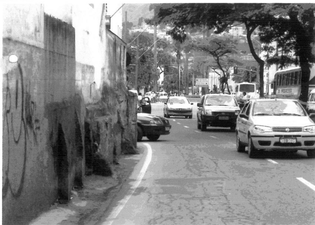
Foto 2: Avenida Independência, via obstruída por prédio Fonte: Processo Administrativo da Prefeitura de Juiz de Fora – MG – nº 7296/2006
