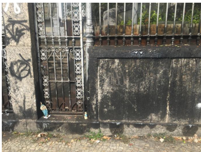
Figura 82. Pilastra com grafites no Mosteiro Nossa Senhora da Conceição da Ajuda e manchamento preto oriundo da cera das velas que ali são acesas e dos depósitos provenientes da queima de combustíveis dos ônibus
