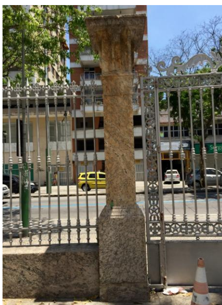
Figura 81. Alteração cromática amarelando as porções superiores nas pilastras da Basílica de Nossa Senhora de Lourdes
