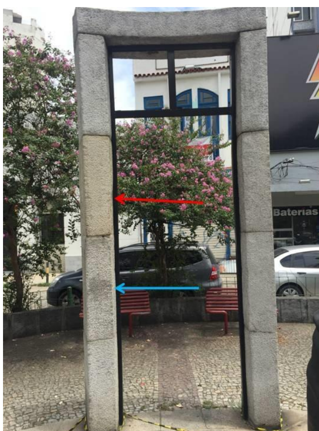
Figura 57. Alteração cromática na pilastra 5
