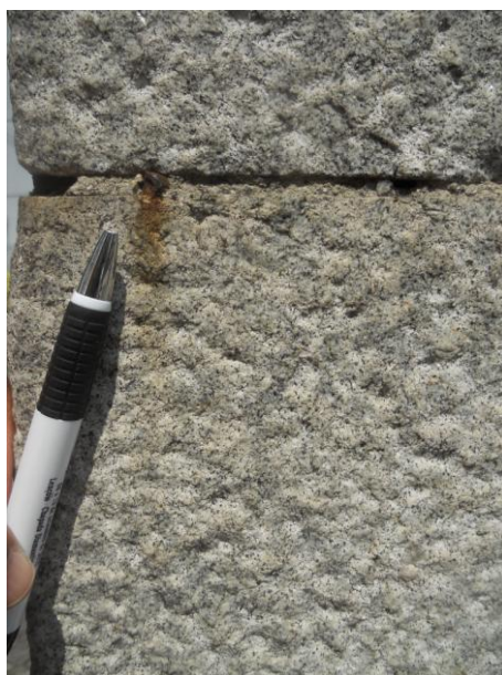
Figura 60. Manchamento avermelhado devido a oxidação da viga de ferro
