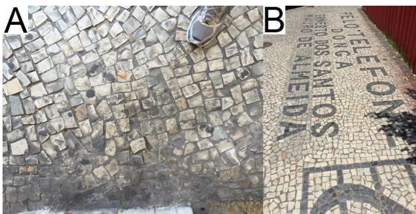
Figura 74. Alterações na calçada: (A) deposição de sujeira nos cantos próximos a parede; (B) manchamento de tinta vermelha à direita
