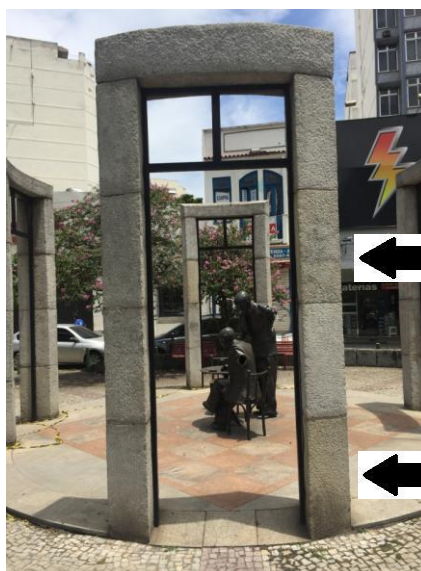
Figura 80. Arco das pilastras 1 (direita) e 2 (esquerda) com alteração cromática nos blocos inferior e no terceiro de baixo para cima em 1
