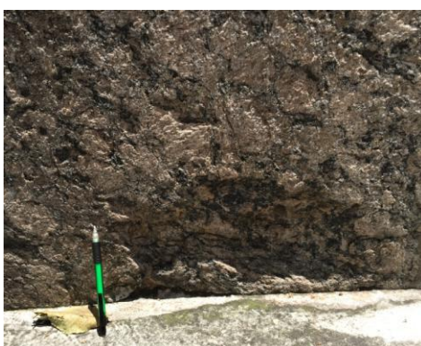
Figura 68. Escamação resultando na perda de massa
