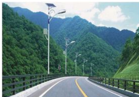
Figura 33 - Iluminação de rodovia com luminárias LED e energia fotovoltaica.
