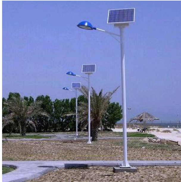
Figura 34 - Iluminação de orla marítima com luminárias LED e energia fotovoltaica.
