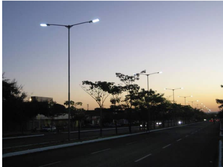
Figura 37 – Poste de 2 pétalas, com luminárias LED LU6 de 112 W.
