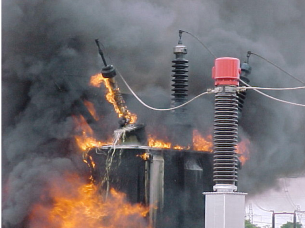
Figura 2 - Bucha de alta tensão e transformador em chama após ocorrência de falha. Fonte: Monitoramento e Diagnóstico de Buchas de Alta Tensão [9].
