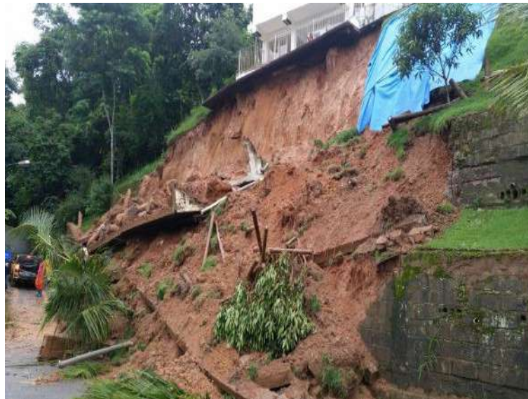
Figura 2.33: Evento de movimento de massa em uma encosta ocupada por residências próximo ao reservatório de Santana em 15/01/16, no município de Piraí - RJ. Foto extraída do Jornal Diário do Vale do dia 16/01/16.
