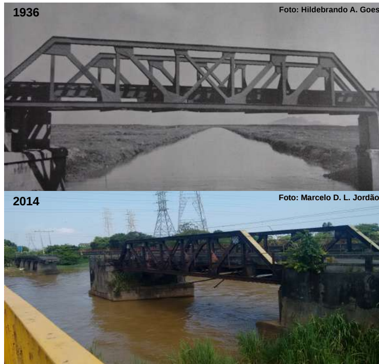
Figura 2.49: Ponte da antiga Estrada de Ferro Central do Brasil (E.F.C.B.) que cruza o canal de S. Francisco. A foto, tirada em 1941 por Hildebrando de A. Goes, mostra o canal de S. Francisco confinado pelo vão da ponte, com aproximadamente 25 m de largura (GÓES, 1942). A segunda foto, tirada em 27/11/2014, mostra o atualmente canal de S. Francisco extravasando o vão da ponte, chegando a ter mais de 60 m de largura em condição típica.
