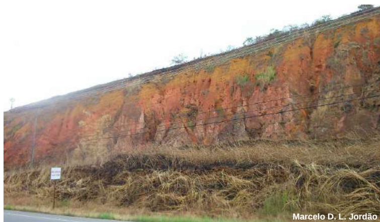
Figura 2.31: Concentração de ravinas degradando um corte da estrada RJ 127 em uma área de pastagens abandonadas, a cerca de 200 m da ponte que cruza o rio Guandu no município de Paracambi - RJ. Foto tirada em 16/06/2015.
