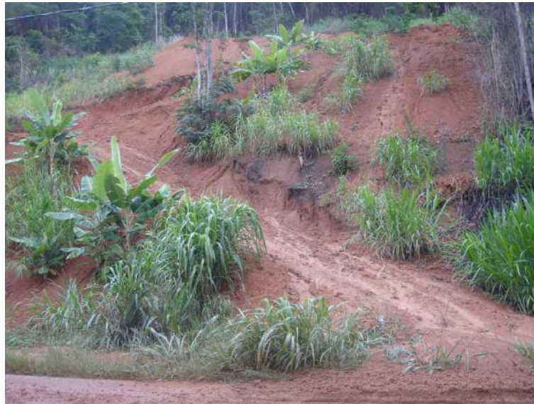
Figura 6.53: Erosão por chuva agindo na obra de corte e terraplanagem de uma encosta às margens direita do rio Pirai, a cerca de 1 km a jusante da estação 2, foto tirada em 27/11/14, as 14 horas, na beira da estrada RJ-145.
