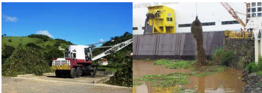
Figura 6.52: Remoção de macrófitas no trecho médio do reservatório de Santana (foto a esquerda) e na tomada da UEL Vigário (foto a direita) (extraído de FERREIRA e R.O. (2014))
