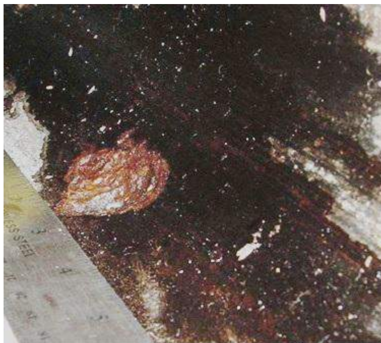
Figura 9: Corrosão interna em duto de injeção de água. Fonte: (47)
