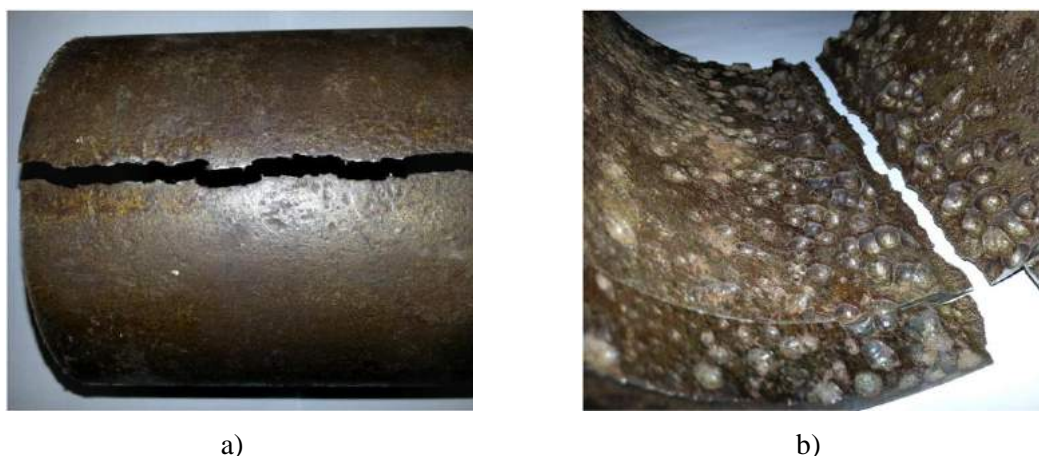
Figura 7: Seção comprometida do duto de água produzida de uma companhia de petróleo operadora na região nordeste do Brasil. a) superfície externa; b) superfície interna com corrosão por pite.
