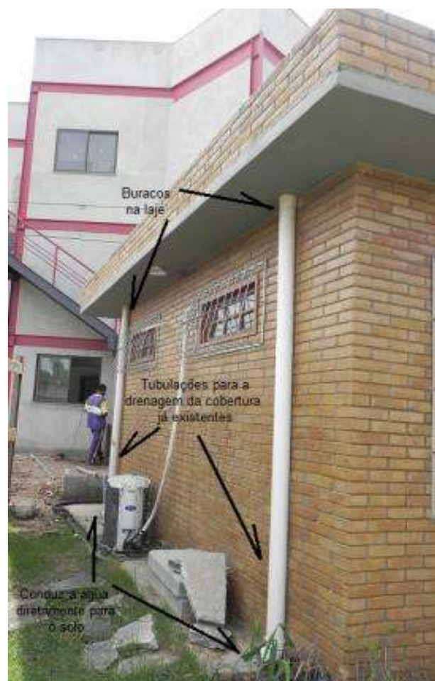
Figura 122 – Foto das tubulações de drenagem já existentes na casa do IVIG/UFRJ.
