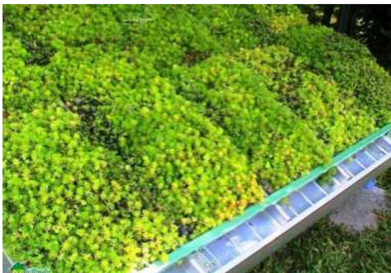
Figura 89 – Sistema modular em um telhado industrial. (FONTE: http://www.ecotelhado.com.br/ , acesso em 2011)
