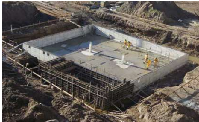
Figura 110 – Um dos reservatórios da Cidade do Samba, Rio de Janeiro.
