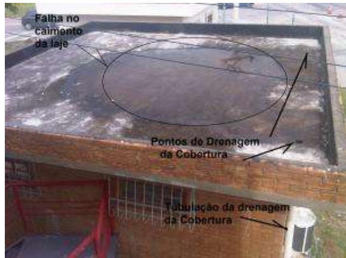
Figura 121 – Foto da laje da casa módulo do IVIG/UFRJ, mostrando a falha em seu caimento e os pontos de drenagem existentes.
