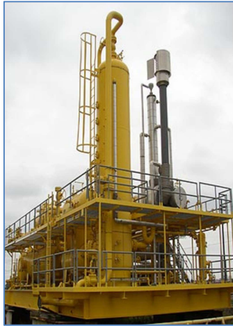
Figura 19: Planta de desidratação por glicol Fonte: TCEQ, 2010
