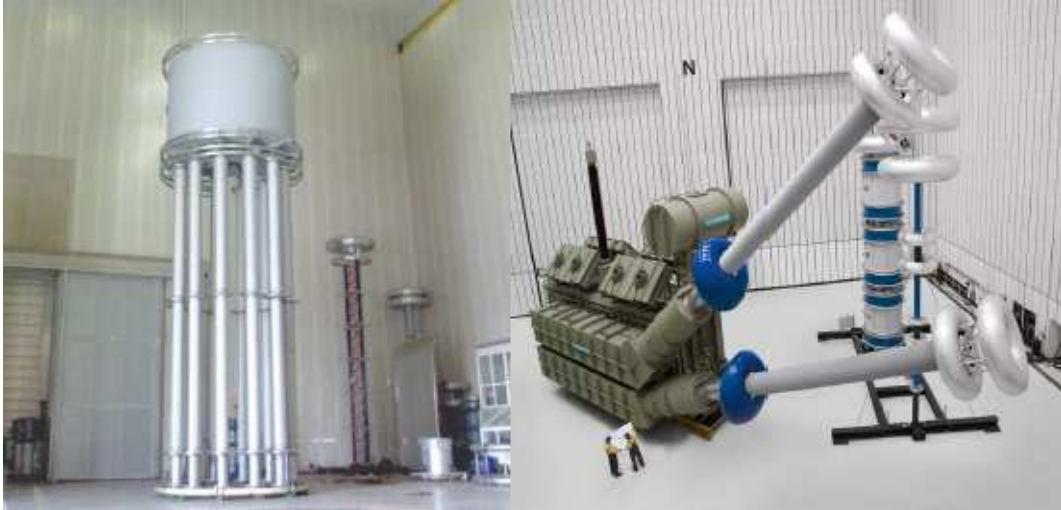
Figura 2.7: : reator de alisamento e transformador - extraídos do site www.cigre.org.br/B4_arg_2008
