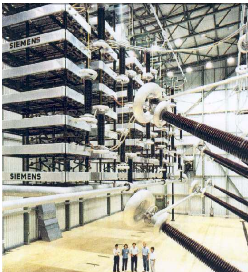
Figura 2.6: Casa de válvulas [3].
