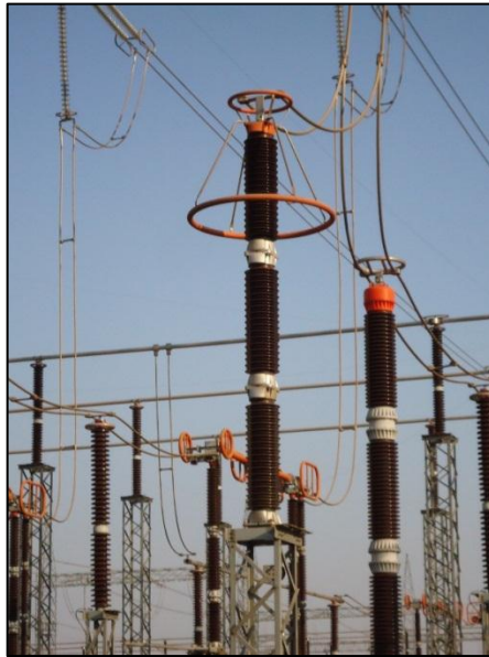
Figura 2.23: Para-raios de 500 kV da SE Itacaiúnas
