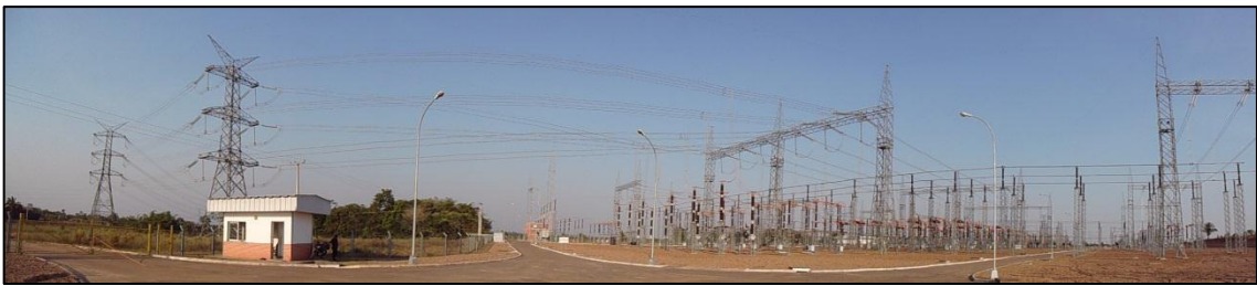
Figura 2.1: Chegada da LT 500 kV Itacaiúnas - Marabá Circuito Duplo ao pórtico da SE Itacaiúnas em Marabá-PA
