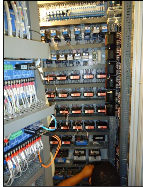
Figura 2.37: Painel de Proteção e Controle (visão interna)
