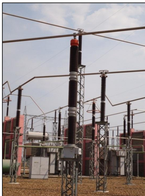
Figura 2.22: DCP de 500 kV da SE Itacaiúnas
