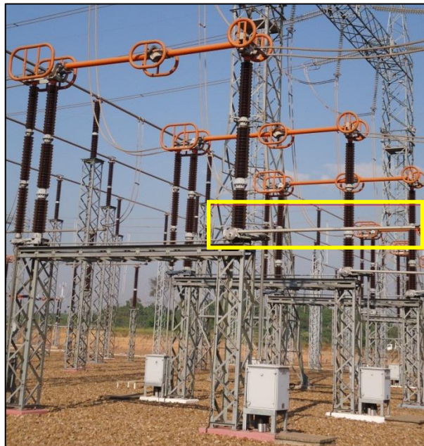
Figura 2.16: Chave seccionadoras com lâmina de terra 500 kV INSL7-02 da SE Itacaiúnas
