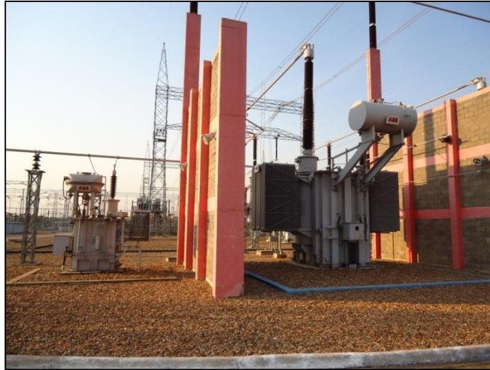
Figura 2.6: Reator de neutro (esquerda) do reator de linha INRE7-02 da LT 500 kV Colinas-Itacaiúnas
