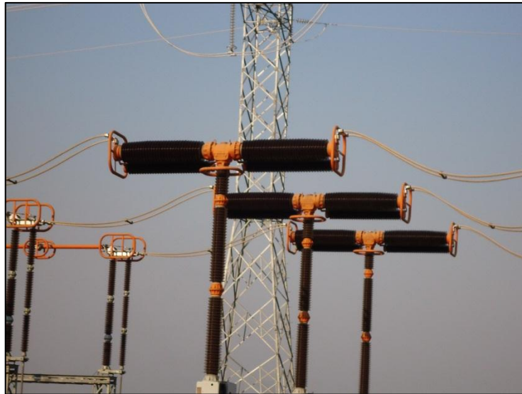
Figura 2.14: Disjuntor 500 kV INDJ7-08 da SE Itacaiúnas
