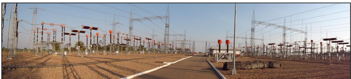
Figura 2.24: Pátio da Subestação Itacaiúnas (Marabá-PA)
