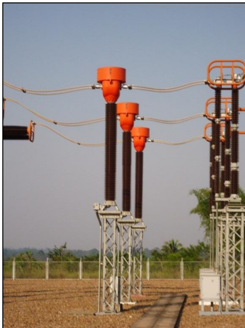
Figura 2.18: TC 500 kV da SE Itacaiúnas
