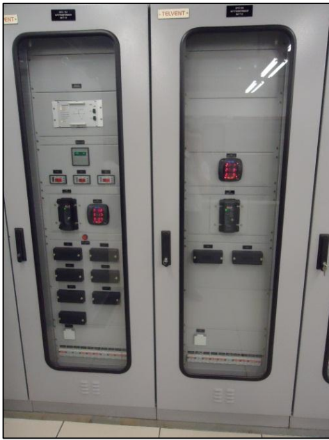
Figura 2.36: Painéis de Proteção e Controle (visão externa)
