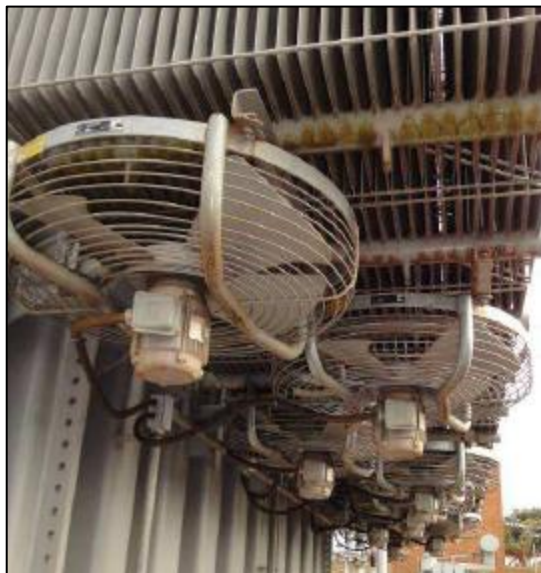
Figura 2.13: Motoventiladores em transformador
