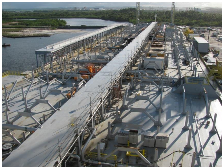
Figura 23 - Vista panorâmica do convés do FPSO e os suportes dos módulos
