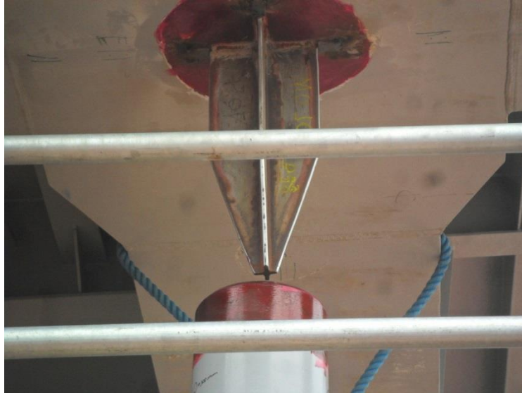
Figura 24 - Detalhe de um dos encaixes do módulo com o suporte sobre o convés do FPSO
