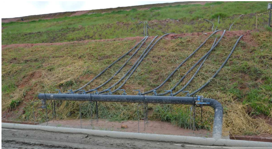
Figura 23: Captação do biogás produzido pelo Aterro da CTR de Seropédica. (Foto: Mariana Costa, janeiro 2013).
